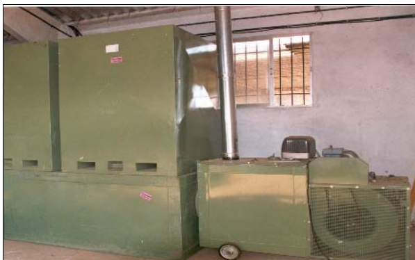
FOTO N° 8: Secadero de aire caliente forzado con salida a seis contenedores de 600 kilos
